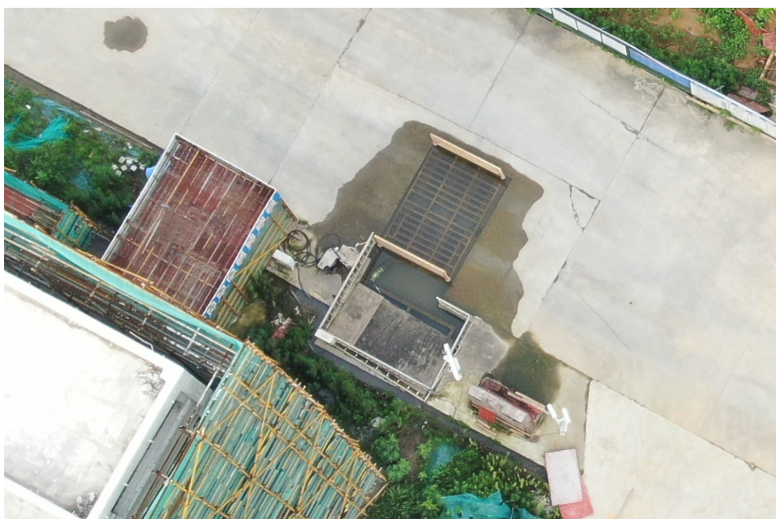
图 4 项目区洗车平台
